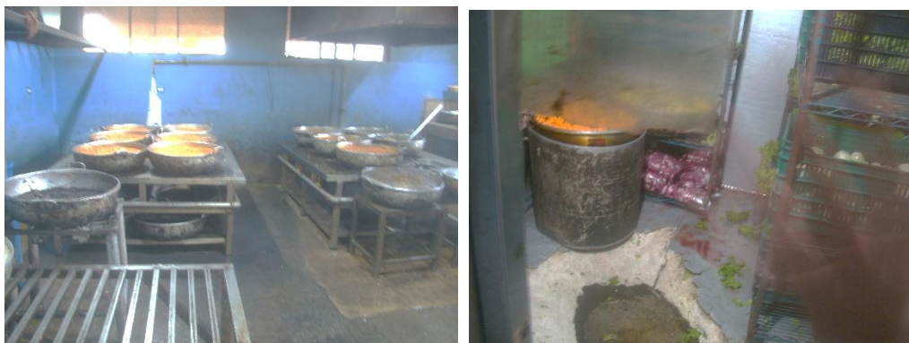
Fotos: pisos y paredes con cemento expuesto en la cocina del CAI Liberia.
